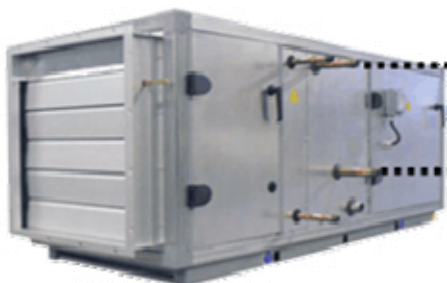
Приточная установка с секцией охлаждения. Расположена внутри помещения.
